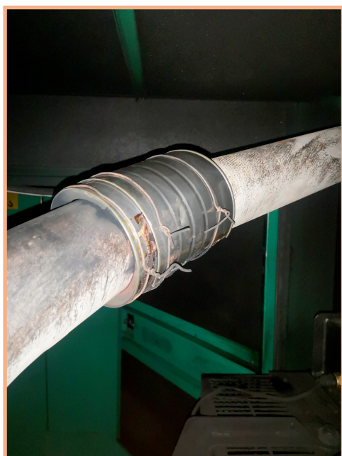
Figura 4 • Remiendo momentáneo que se torna definitivo. Fondecyt MaReCe, noviembre de 2021.
